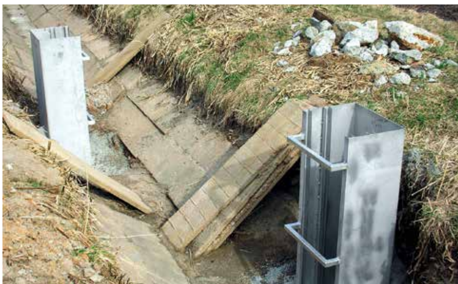
Einlassständer im Zulaufgraben in moderner Edelstahlausführung
